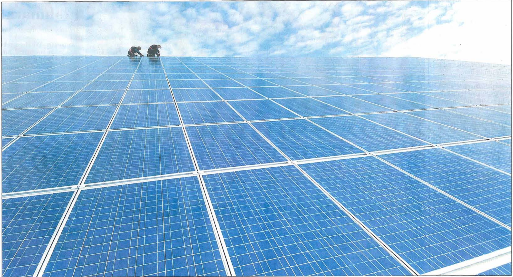
Strom für 50 bis 60 Haushalte: Auf dem Dach der großen Lagerhalle der Firma EWS sind 650 Solarzellen montiert – die größte Dachanlage der Region.
