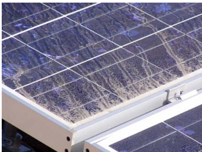
Fig. 2: Staubniederschlag auf Solarmodulen
